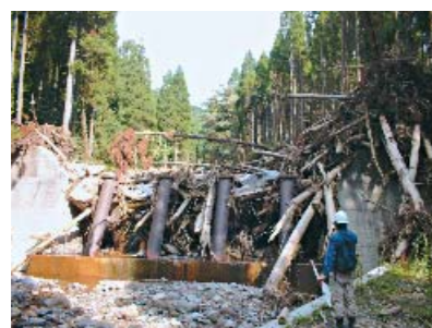
土石流を食い止めた砂防えん堤 [2005年 熊本県]
