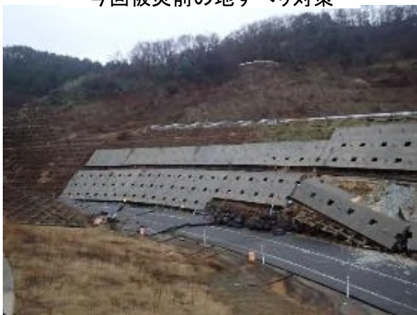
R6被災状況: グラウンドアンカー施工のり面の被災
