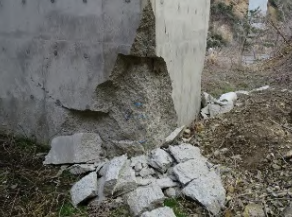
橋脚基部の損傷
