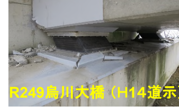
ゴム支承の残留変形
