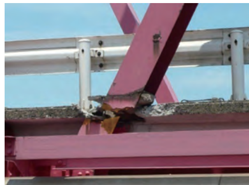
国道23号木曾川大橋斜材破断
