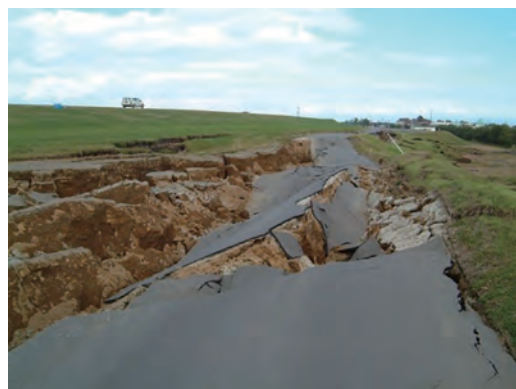
十勝沖地震被害
