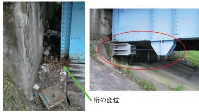
写真-1.1.7 支承部の破壊と作動した落橋防止構造
