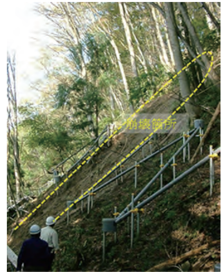
写真-1.2.4 光ファイバセンサ及び表層崩壊跡
