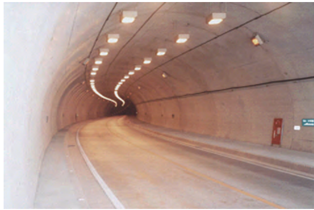
写真-1.3.3 カウンタービーム照明の適用例(新与那トンネル 国道58号)
