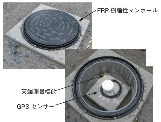
写真-3.2.7 天端埋設型GPS
