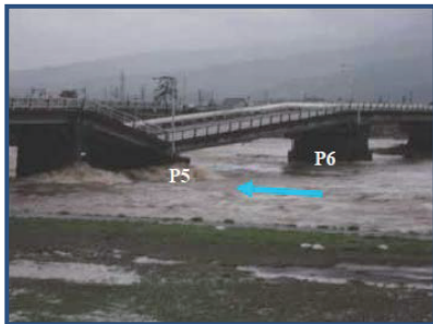
橋脚周辺の局所洗掘
