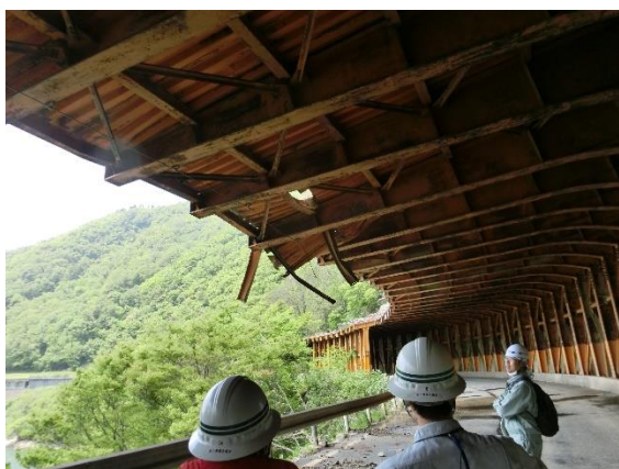
写真-3 スノーシェッドの被災状況確認
