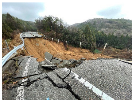
写真2 のと里山海道における盛土変状
