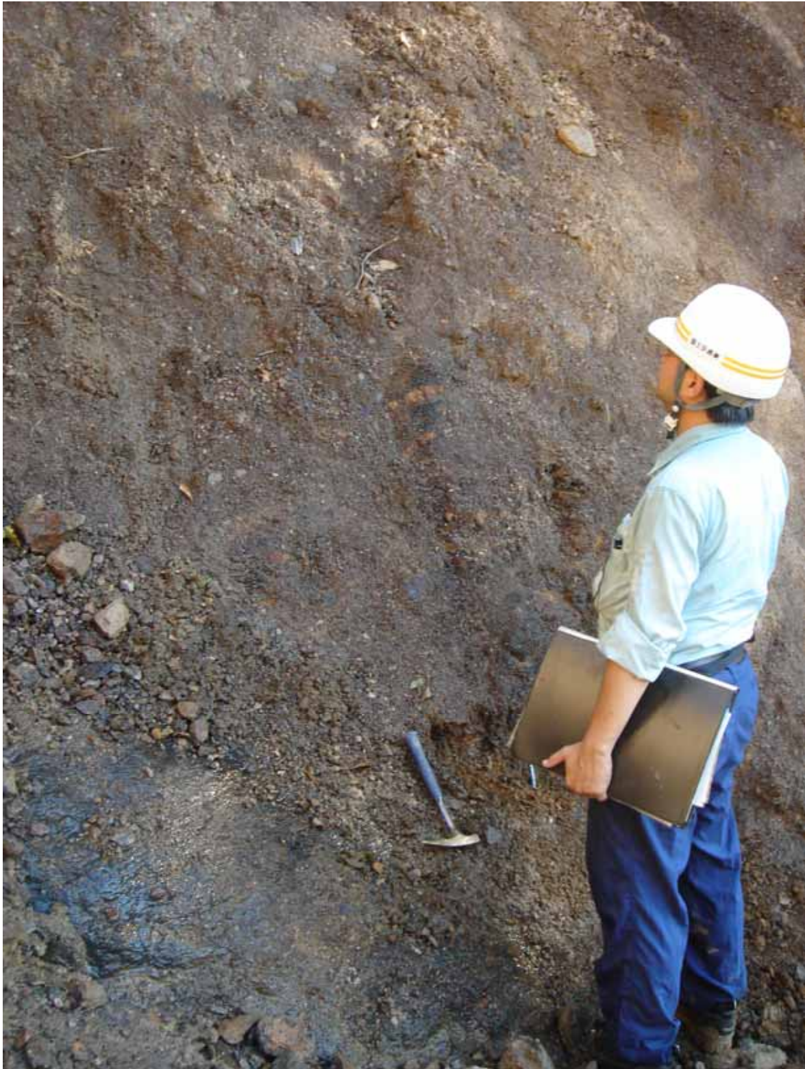
写真 -7 崩壊左側部。ハンマーより下の黒色部が崩壊面。ハンマーより上部は未崩壊部（残存部）である。このことから、崩壊部は、かなり風化・脆弱化した岩盤（破碎質の泥質岩、メランジエカ）であったと推定される。
