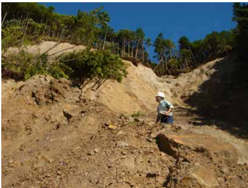
写真 -5 崩壊中央部付近には崩土がかなり残存している。崩壊頭部もわずかにオーバーハングし、風により樹木がゆれて落石が落ちてくる状況。
