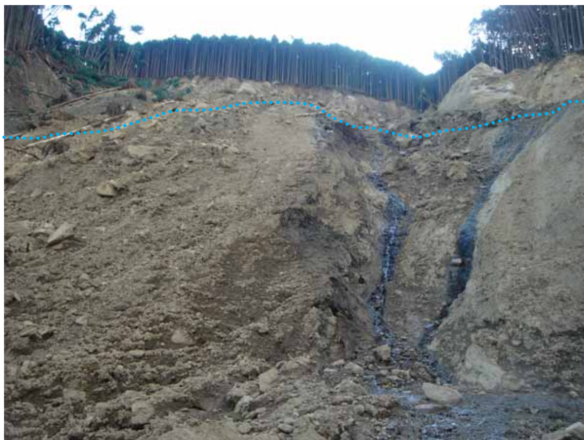
写真 -10 崩壊面（青点線）の直下の急崖と岩盤露頭（水が流れている部分）。（急崖部の位置は断面図参照のこと。岩盤露頭の接写は写真 -3）
