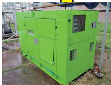
消化ガスエンジンシステム
