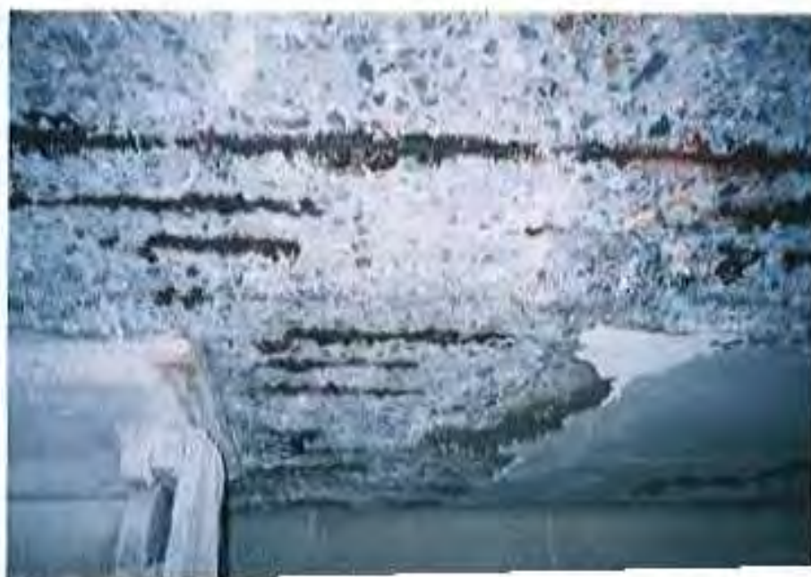
栈橋の床スラブ下面の鉄筋の錆
