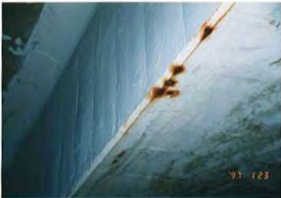
R C 桁下面の点錆
