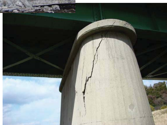
橋脚天端付近の損傷
