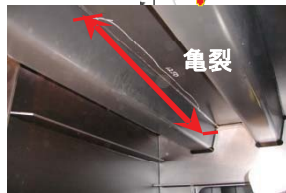
鋼床版で発見された亀裂
