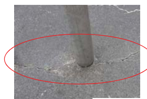
関連部位の損傷
