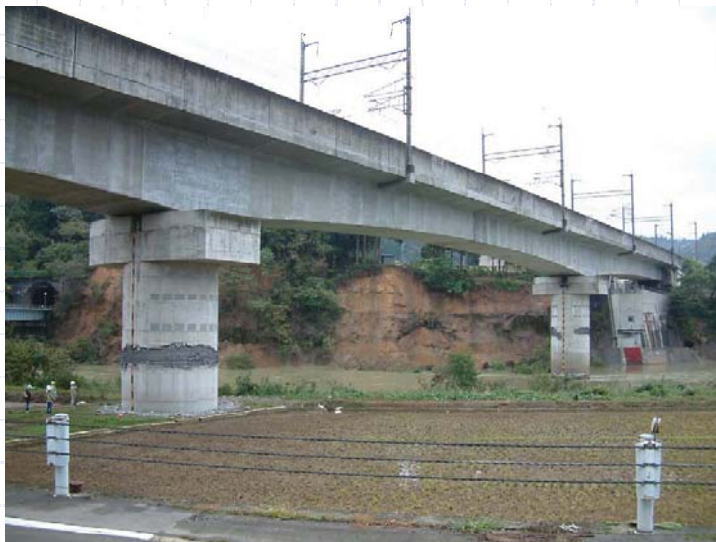
上越新幹線：段落し位置の損傷
