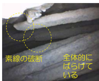
例②：大部分の素線の破断
