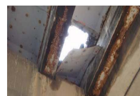
接着鋼板のため 床版の劣化状況の把握困難
