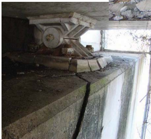
橋脚天端付近の損傷
