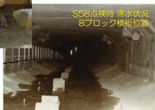
S54点検時 滞水状況 3ブロック定着部付近
