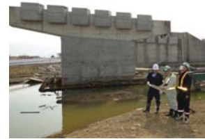
地震による落橋
