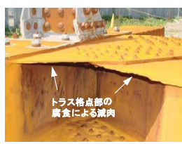
トラス格点部の腐食状況
