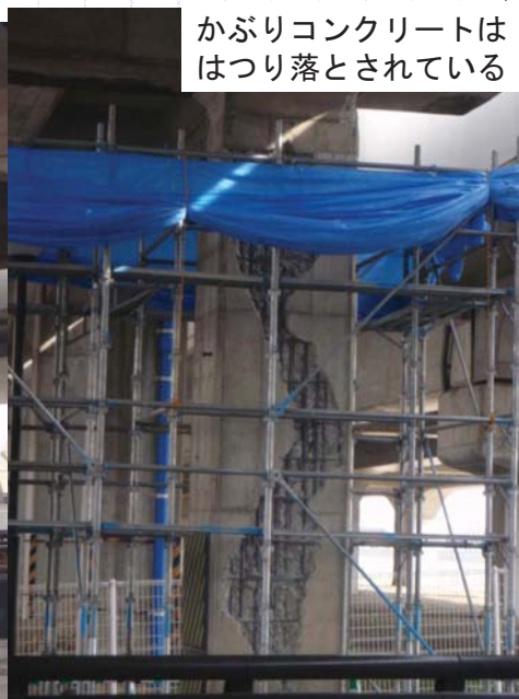
RC柱のせん断による損傷
