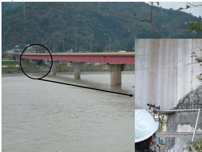
小千谷大橋：段落し位置の損傷
