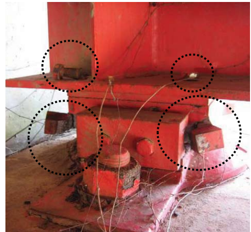
固定支承の損傷
