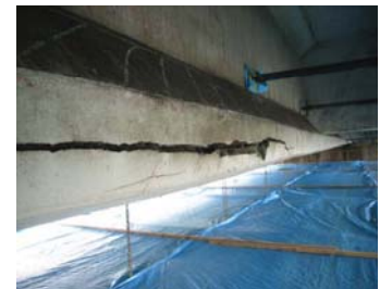
塩害(能生大橋)
