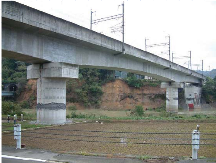
上越新幹線：段落し位置の損傷
