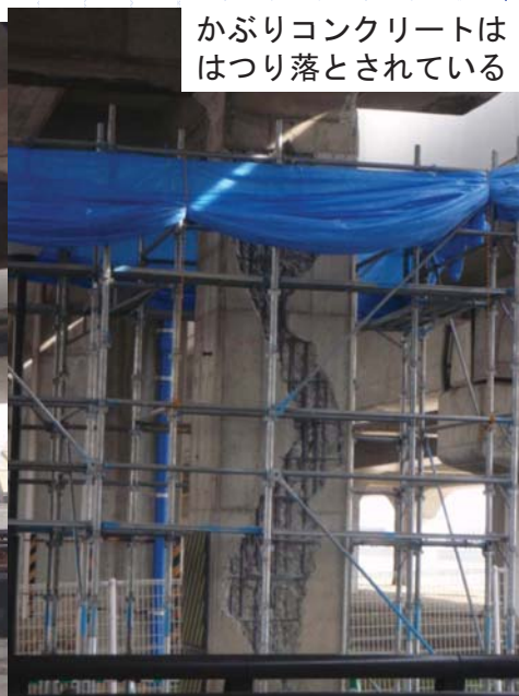
RC柱のせん断による損傷
