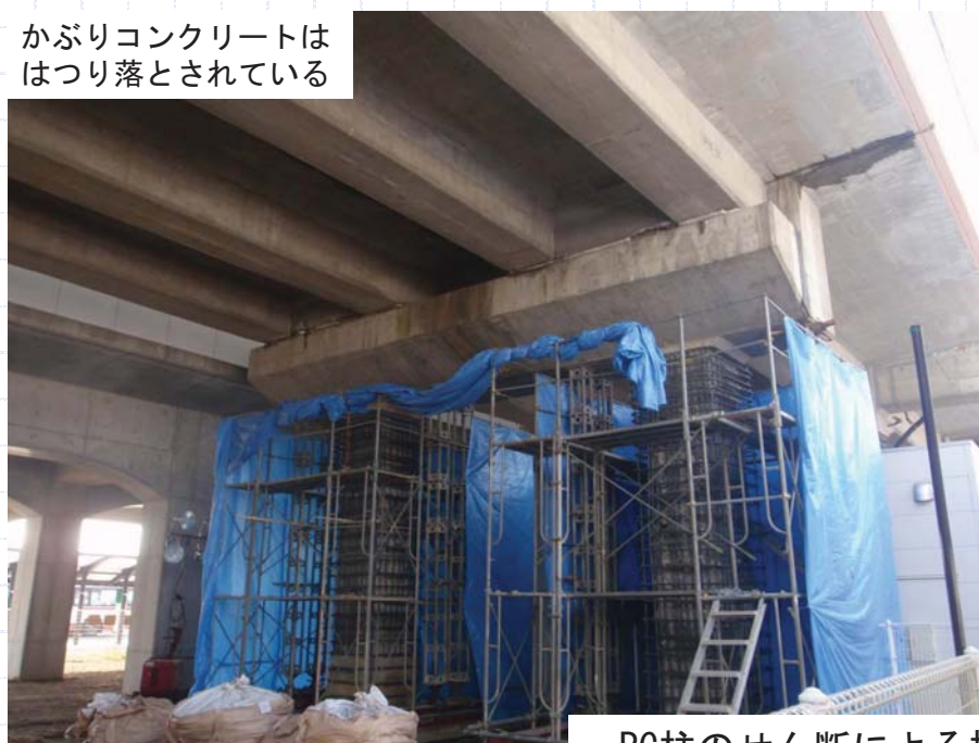
RC柱のせん断による損傷
