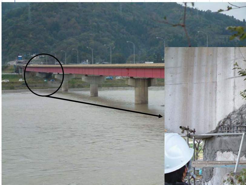
小千谷大橋：段落し位置の損傷
