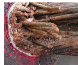
下流側NO. 11 先端が細く脆性的な破断状態である
