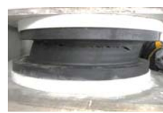
免震支承の亀裂
