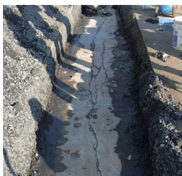
橋面での鉄筋破断 (段落し部)
