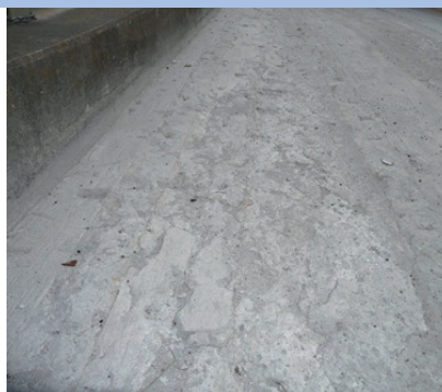
橋面コンクリートの 骨材化 (鉄筋の外側)
