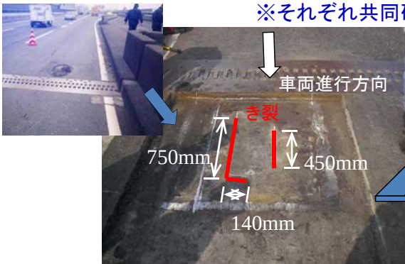
舗装下に貫通したき裂(デッキ進展き裂)
