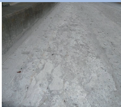
橋面コンクリートの骨材化 (鉄筋の外側)
