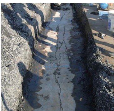
橋面での鉄筋破断 (段落し部)
