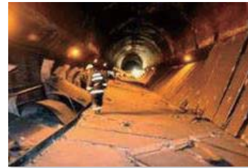
笹子トンネル事故(2012年12月)
