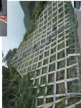
点検用通路を設置した事例
