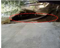
壁面背面排水層の未設置
