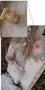
補強材の破断
