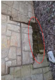
壁面からの水の染み出し
