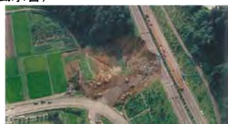
台風の大雨による 盛土法面崩落(H11.8) → 地下排水構造物の分断が原因 復旧に1ヶ月
