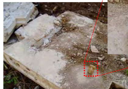
補強材の破断
