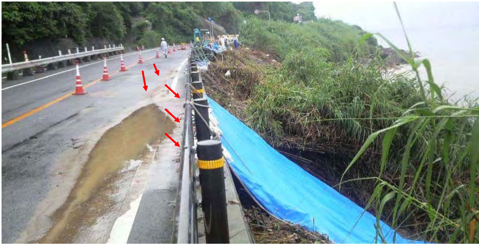
路面の表流水が流入した痕跡あり
