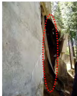
壁面背面排水層の未設置
