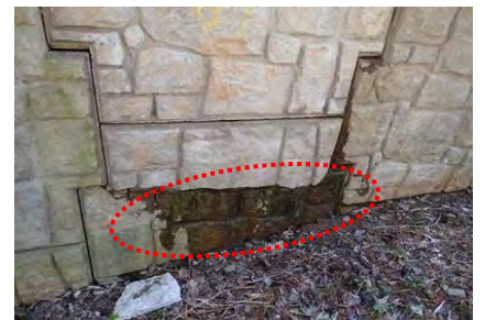
壁面からの水の染み出し
