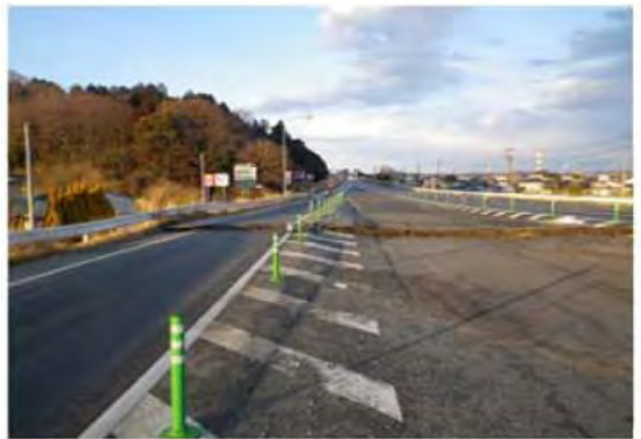
カルバート背面の段差
