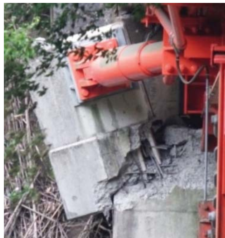
写真2 ダンパー取付部の損傷
