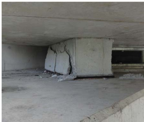
写真1 アンカーボルト定着部の損傷
