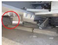
写真-4 支承の破損の状況
