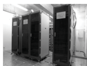
サーバラック (情報通信室)
