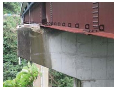
写真-4 ゴム支承の破壊 (P2橋脚)
