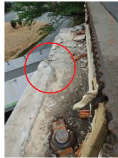
写真-3 斜角側橋座部に に残された擦過痕
