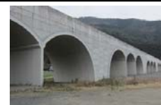
アーチカルバート
