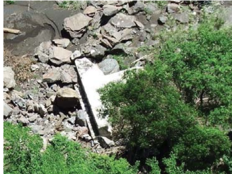
写真-4 橋脚の流出
