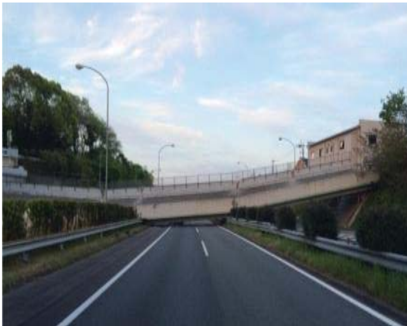
写真-1 落橋の状況
