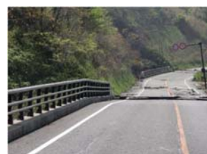
写真-2 A1-P1間での上部構造の屈折
