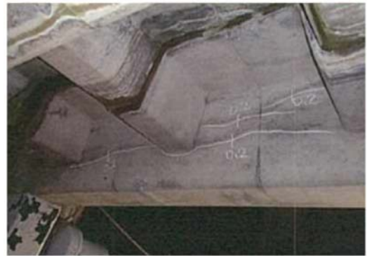
主梁のひびわれ
