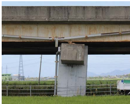
高速道路の橋脚の傾斜(熊本地震)
