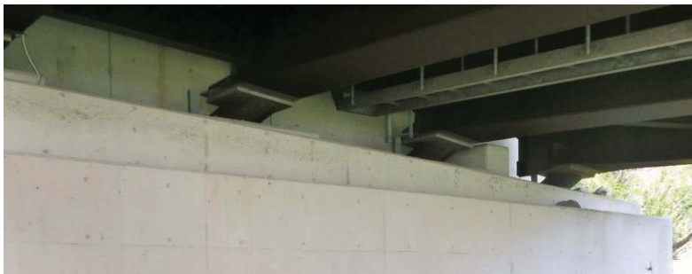
写真-2 A2橋台ゴム支承の残留変形
