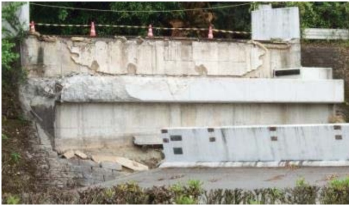
写真-2 A1橋台の損傷
