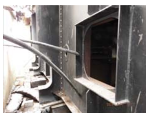
写真-4 落橋防止ケーブルの破断
