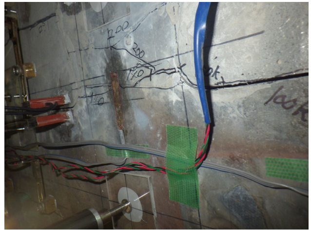
(d) 供試体 JS1, プレキャスト側突起部のひび割れ
