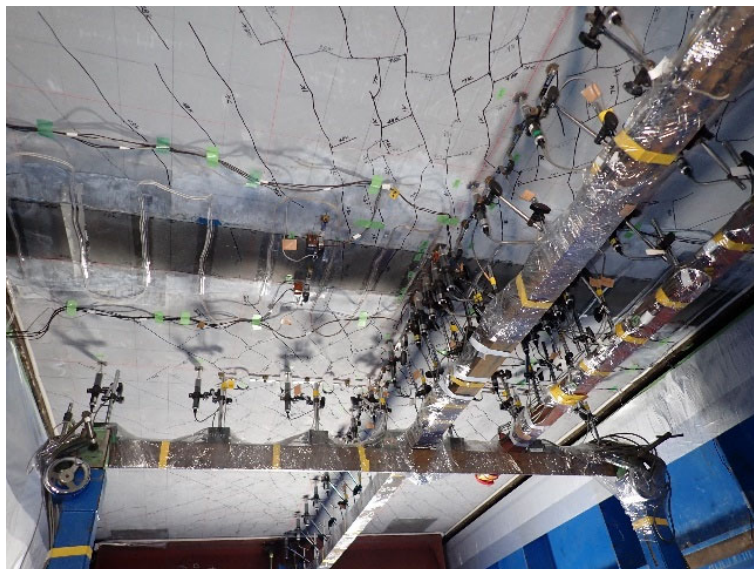
写真-2 漏水確認状況
