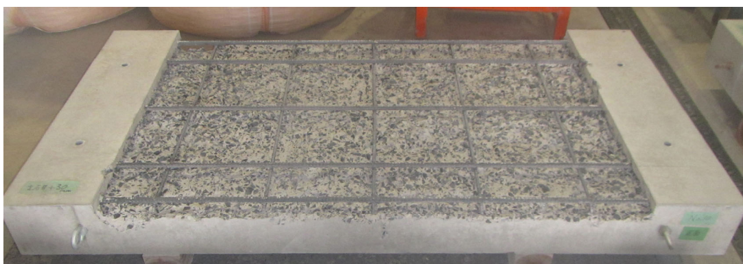
図-1.2.1.2 ウォータージェットによるはつり後の全体状況 (目標はつり深さ 60mm)
