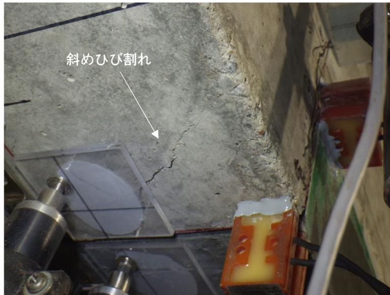
(b)供試体 D の下面に発生していた斜めひび割れ
