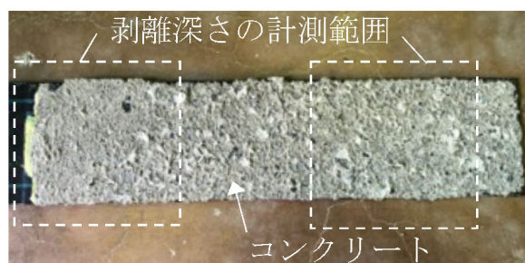
図 4.2.5.1 剥離後の CFRP シートと計測範囲
