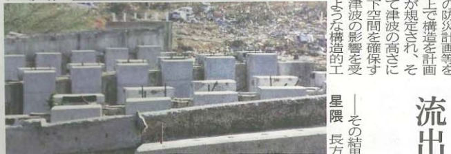
上流側の変位制限構造の損傷
