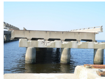
(b) Actual Bridge damage 3)
