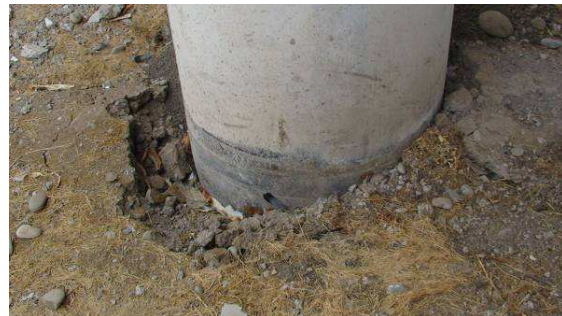
(d) Soil separation from column
