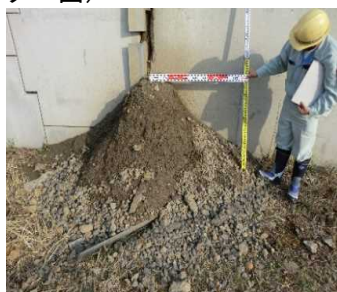
写真-1 連続構造物接続部の開きによる盛土材漏出事例
