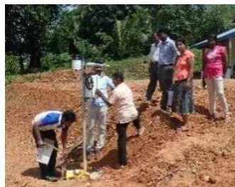
図-2 地上雨量計の設置
