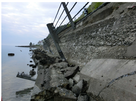
写真 - 1.2.3.3 国道228号の海岸擁壁倒壊
