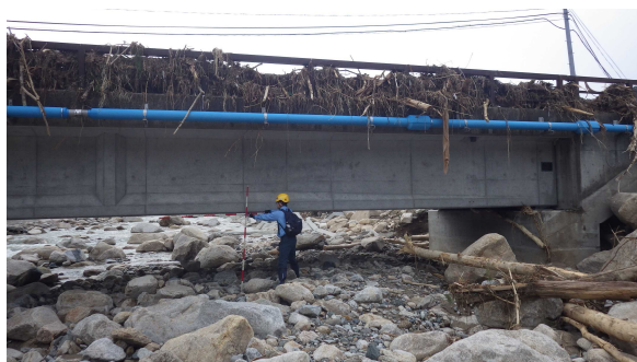
写真 - 1.1.3.17 宮城県伊具郡丸森町における土砂災害箇所の調査の様子
