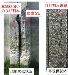
写真-3 矢板の劣化状況と再現供試体
