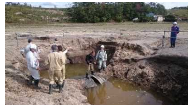
写真-1 地震災害における農業用管水路の継手部離脱による漏水事故の状況
