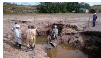
図-1 平成30年北海道胆振東部地震における農業用管水路の被害事例
