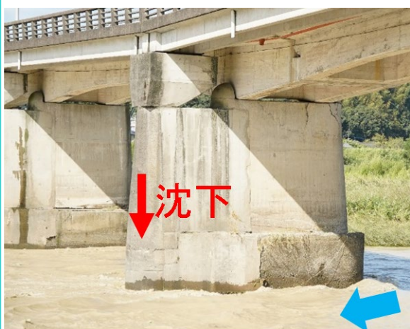
写真-1 橋脚の沈下
