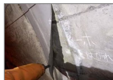
(a) はく落対策工※背面からの漏水によりシートがはく離
