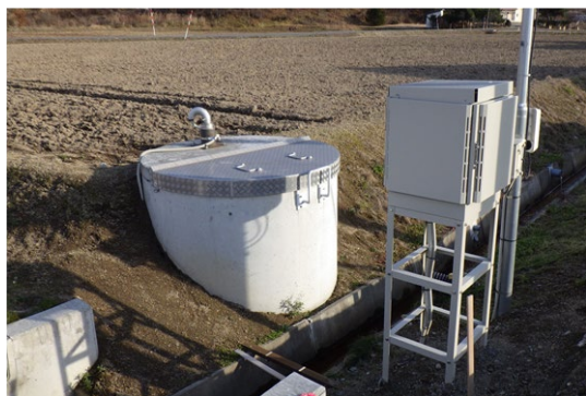
写真-1 農業用パイプラインにおける地震時動水圧の観測システム
