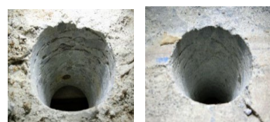
(a) 実橋損傷 (b) 損傷模擬 写真-1 橋梁 RC 床版内部損傷の発生状況
