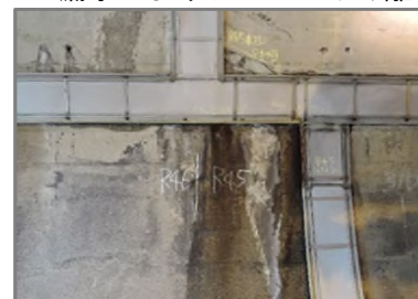
(b) 漏水対策工※シール部の劣化により漏水が発生
