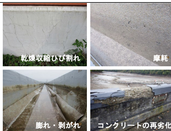
図-4 補修・補強後の用水路の代表的な変状
