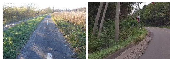
図-5 自転車走行空間現地調査での舗装損傷の一例
