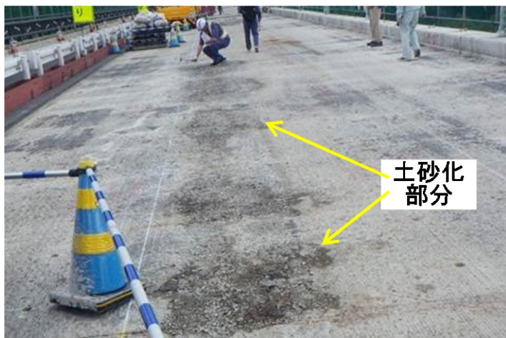
写真-1 土砂化による床版の劣化事例
