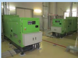
堀之内浄化センターでの設置状況
