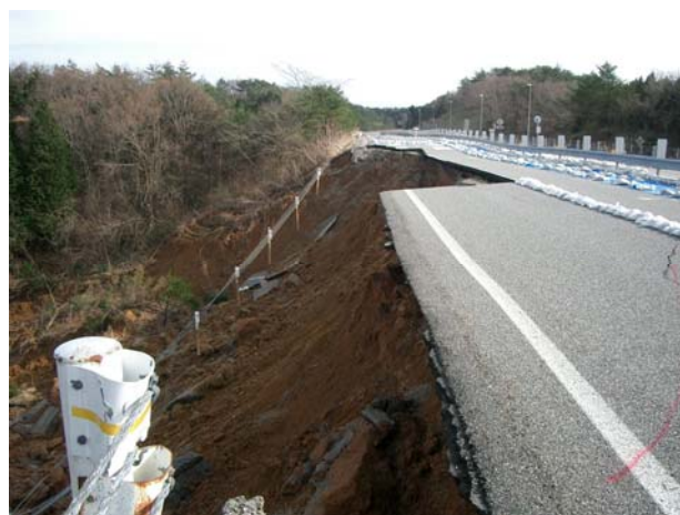
写真1.1 能登有料道路の盛土崩壊
