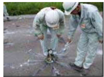
写真-10 透気量試験状況
