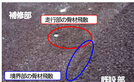
写真 - 18 加熱タイプの荷重車走行後路面
