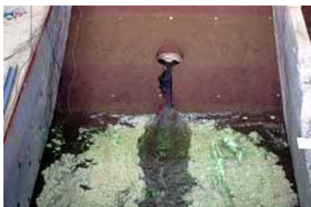
写真-2 パイピングの状況
