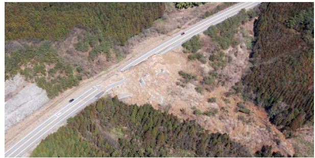
写真-2.1 能登有料道路（縦38）の崩壊状況 1)
