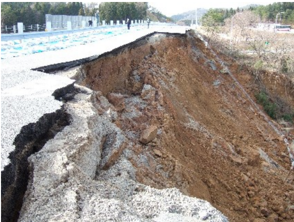
写真-2.1 別所岳SA近傍の路面崩壊 (能登有料道路17.7kp七尾市中島町田岸)
