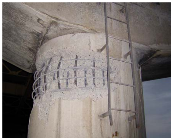
図-1 過去の地震による RC 橋脚の段落し部の損傷 2)
