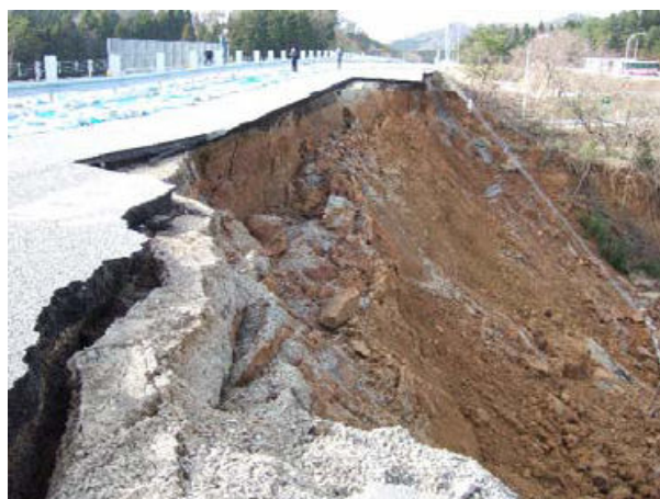
写真1.1 能登有料道路の盛土崩壊
