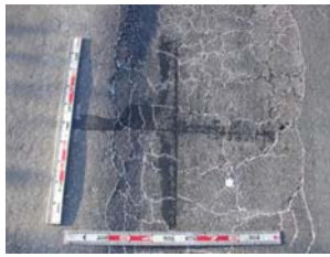
写真-7 舗装のひび割れ (試料D)
