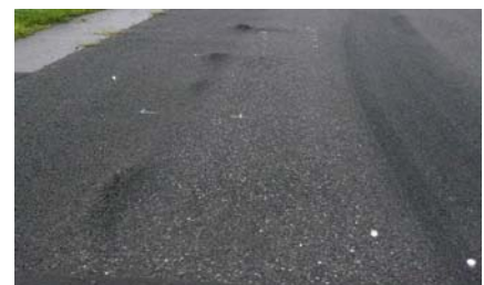
写真-12 排水性舗装の破損 (側方流動)
