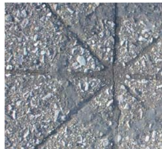
写真-5 シール材自体 の割れ (試料A)
