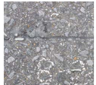
写真-6 舗装との界面 の剥がれ (試料E)
