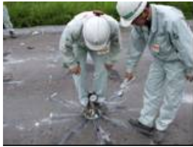
写真-3 透気量試験状況
