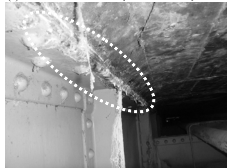
(f) 漏水による主桁上フランジの腐食
