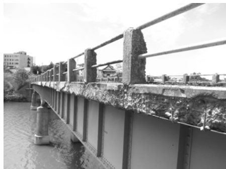
(a) 凍害による地覆コンクリートの剥落
