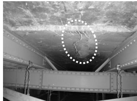
(e) 床版部分打替え部（ハンチなし）のひび割れ
