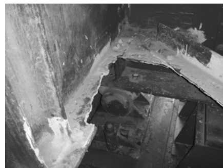
(a)端横桁下フランジの腐食欠損
