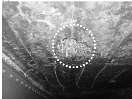
(c) 床版コンクリートの剥落
