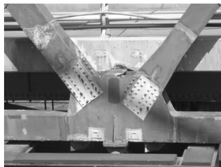
(b)支点上格点部周りの腐食
