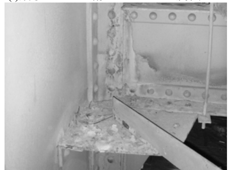
(g) 床版コンクリートの剥落
