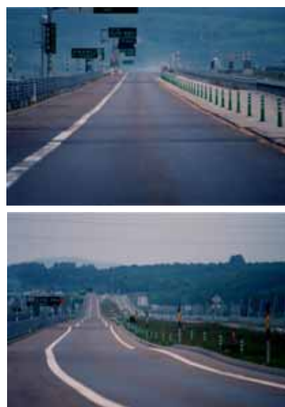
写真1 供用4年目の路面沈下 (上: 粘土地盤、下: 泥炭地盤)
