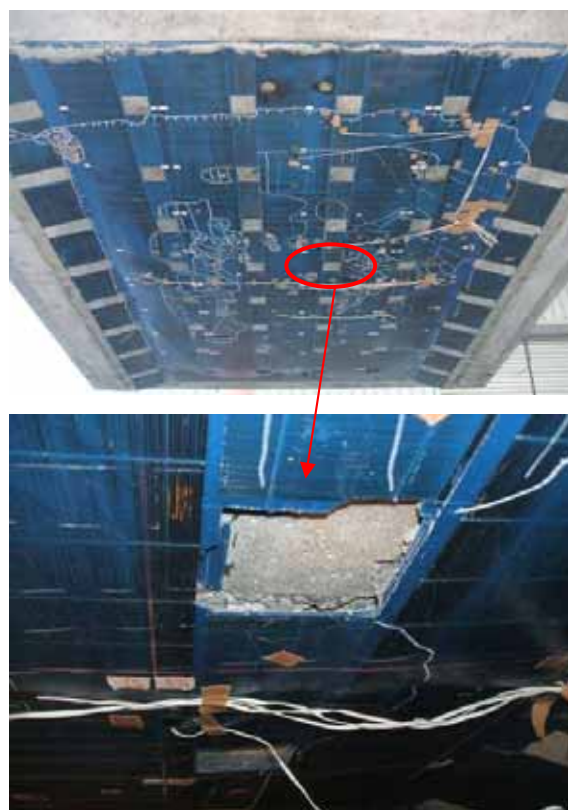
写真 - 2 破壊状況
