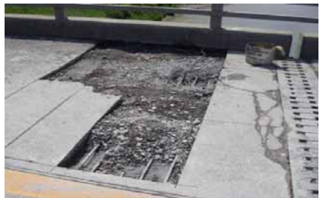
写真 - 1 凍害損傷（砂利化）状況
