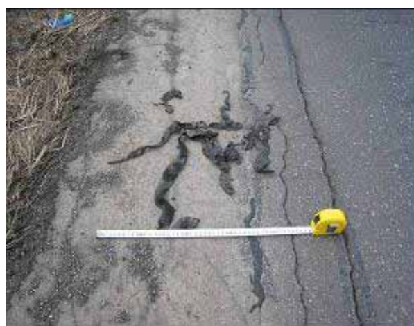
写真-1 シール材が剥がれた状況
