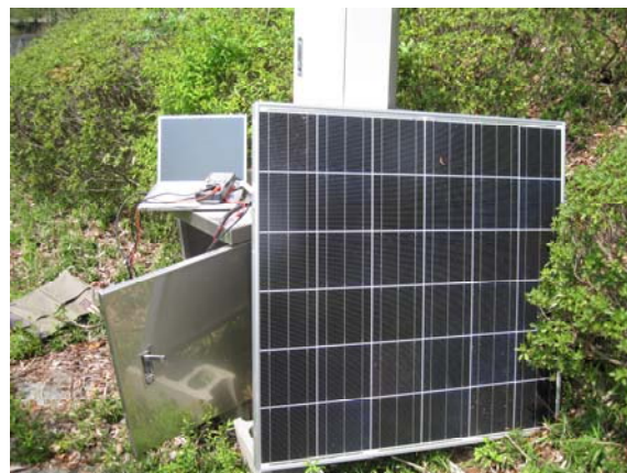
図-5 太陽電池パネルの発電量計測状況
