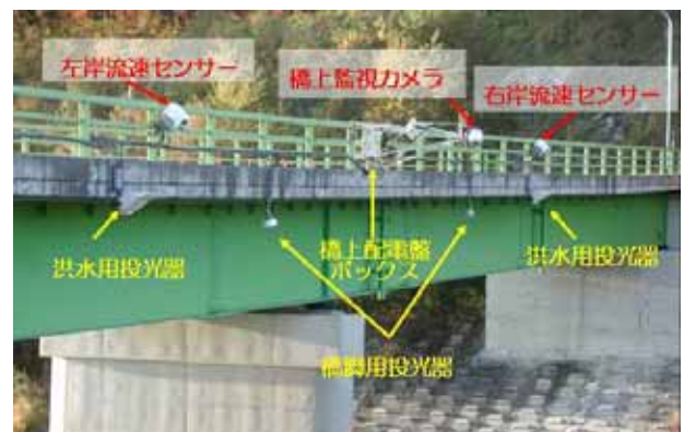
図-15.5.4 観測機器設置状況(沙流川平和橋)
