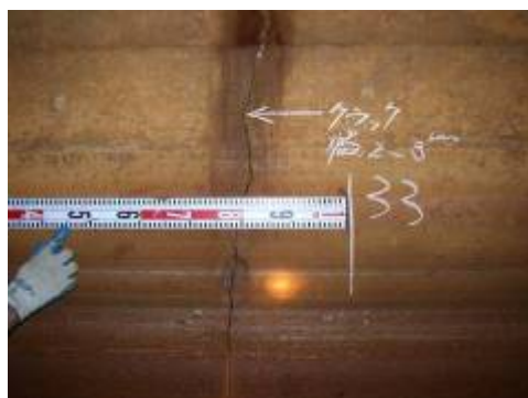
図-3.7 函体に生じたクラックの一例 (スパン3)
