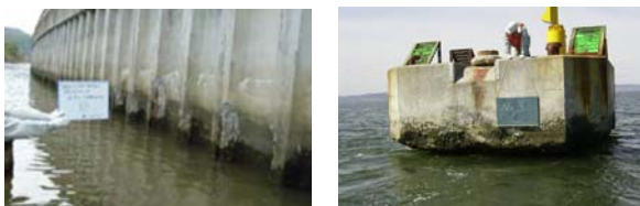
図-5.1 流水の作用によるコンクリート構造物の劣化の例
