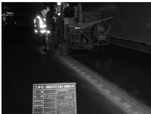
図11 トンネル内に設置されたランブルストリップ (一般国道333号新佐呂間トンネル)
