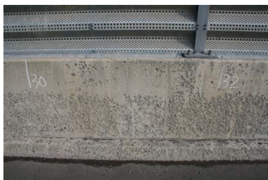
写真-3.6 スケーリング劣化状況(水みち部・南向き)
