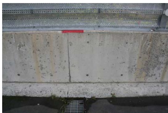
写真-3.5 スケーリング劣化状況(水みち部・北向き)
