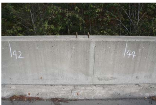
写真-3.7 スケーリング劣化状況(一般部・南向き)
