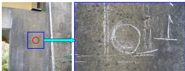
写真-3.9 A橋橋台堅壁側面部分(劣化部)
