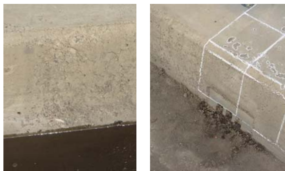
写真-3.7 路面水の滞留（左）マスの詰まり（右）
