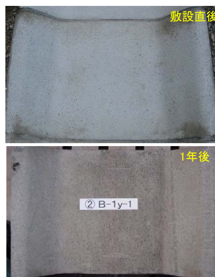
写真-2.2 即脱型の表面状況の経年比較
