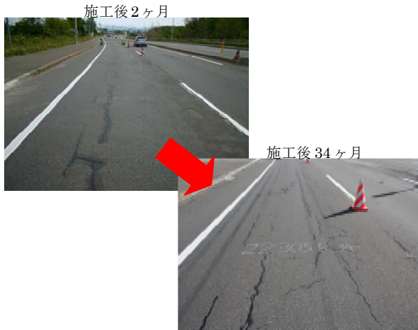
写真-1 現地経過写真（トップダウンクラック箇所）
