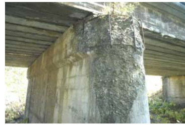
図-7 凍害による橋脚のスケーリング
